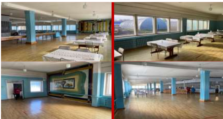
Рисунок 1 – Фотофиксация дефектов и повреждений столовой №5
