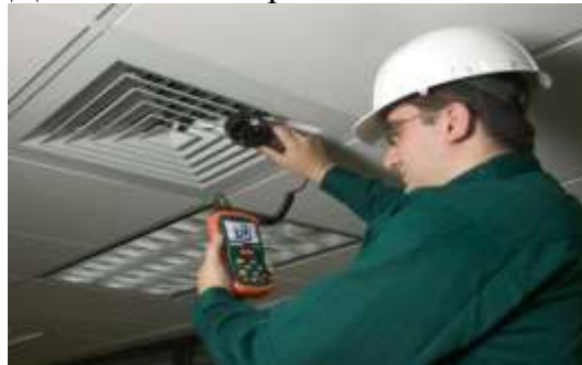
Рисунок 2 – Диагностика вытяжной системы вентиляции
