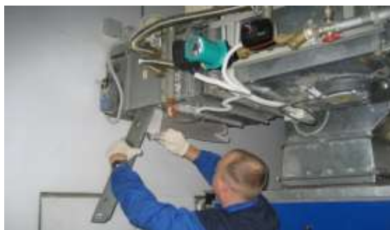
Рисунок 3 – Диагностика приточно-вытяжной системы вентиляции
